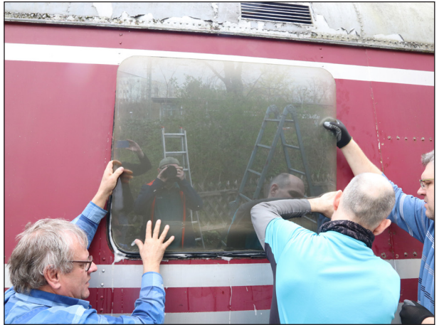
Das zweite Fenster war keine wirkliche Herausforderung mehr. Klaus Probst (2. v. links) fotografierte das Wiedereinsetzen der Scheibe.
